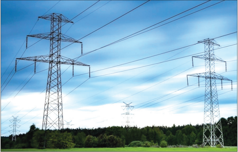
یک ایستگاه انتقال نیرو در استان خراسان جنوبی
